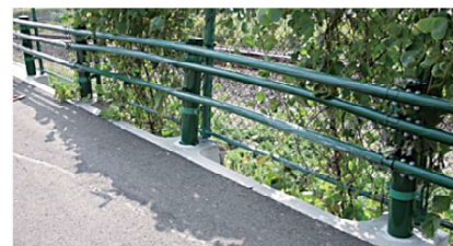
衝突した後の状況
