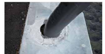
縦断方から見た支柱の変位状況
