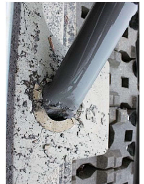
1本目のひび割れ状況
