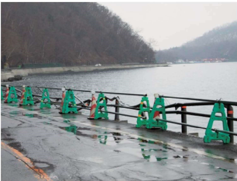
トレーラーがガードパイプに衝突した現場の全景
