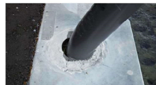
縦断方から見た支柱の変位状況
