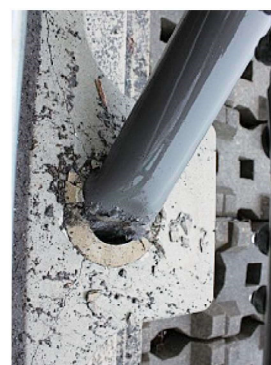
1本目のひび割れ状況
