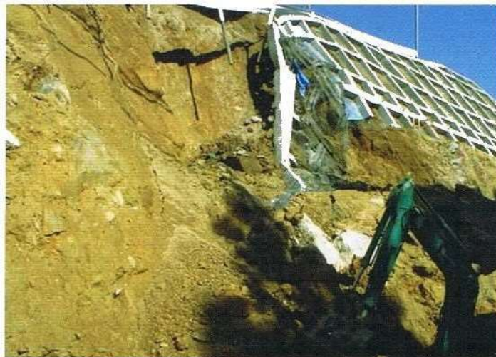
崩壊したアンカー壁・右側
