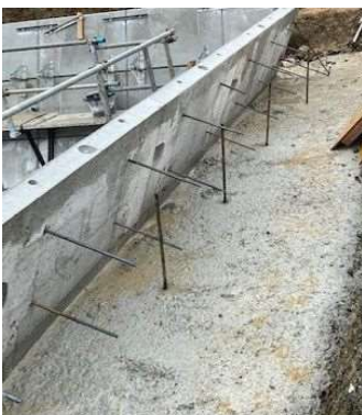
サポート筋が無い背面状況
