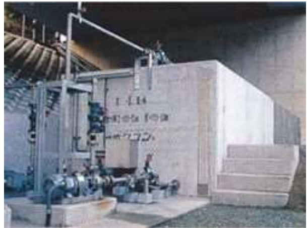
■融雪水回収槽
