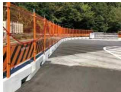
NEXCO中日本 東名高速道路 鮎沢PAランプ新設工事（A型）
